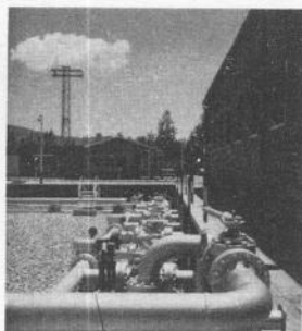
عکس روی جلد : یکی از ایستگاههای مخازن خطوط لوله
